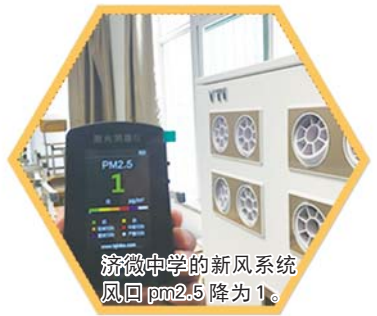
济微中学的新风系统,风口pm2.5降为1。
